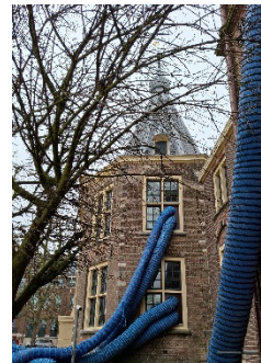
(Afbeelding 6: Tijdelijke klimaatinstallatie AZ)
